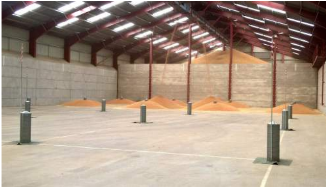
Colonnes FloorVent - idéales pour le stockage de volume important de grains et les tas profonds
